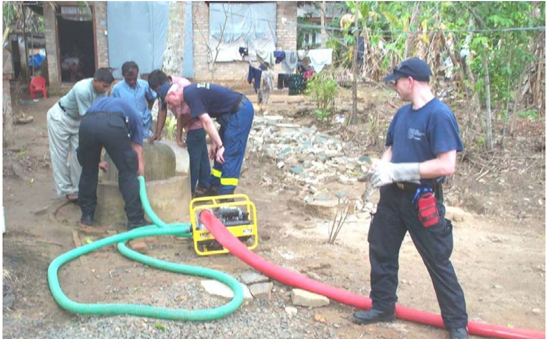
Abbildung 2: Durch Abpumpen mit Feuerwehropumpen konnte so mancher Brunnen nach der Überflutung mit Meerwasser dank des Einsatzes der Europäischen Brunnengesellschaft wieder in Betrieb gehen.
